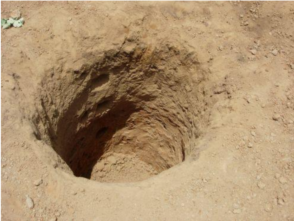
Illustration 2: creusage du puit. L'eau devrait se trouver à 5 ou 6 mètres. Comme le sol est sableux, il faudra maçonner les bords du puit pour éviter qu'il ne s'effondre dès les premières pluies.
